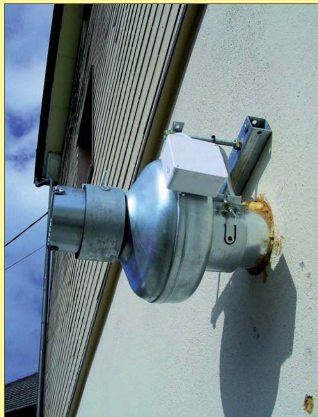
Abluftventilator an der Außenmauer
