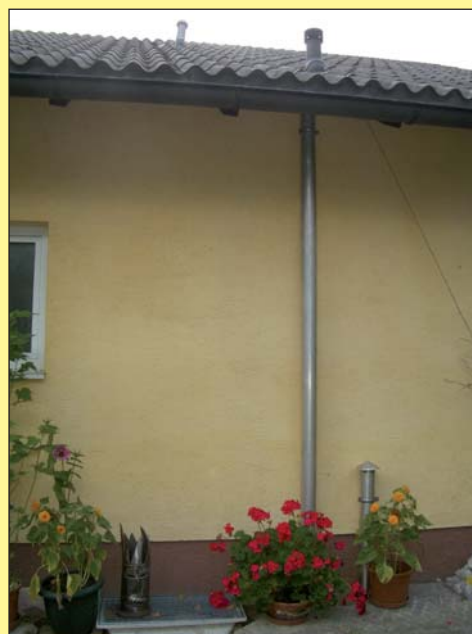
Abluftrohr über Dach mit Ventilator
