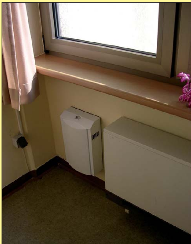
Zuluftventilator unter dem Fenster
