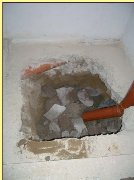
ca. 1 x 1 m Schacht mit Entlüftungsrohr
